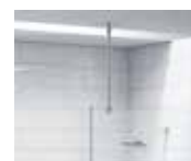
Barre verticale attachée au plafond
